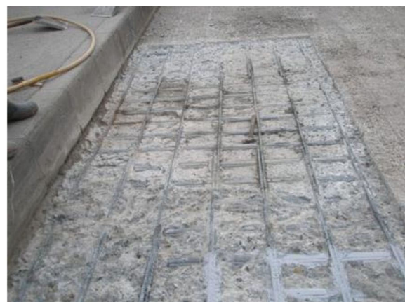
舗装の異常箇所、グレーチング床版の漏水・遊離石灰箇所、床版の脆弱箇所の撤去状況。鉄筋の一部に腐食が見られる。
