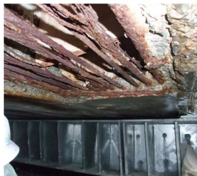
桁下面のPC鋼材の腐食、破断状況 硬化コンクリート中の空気量は約0%
