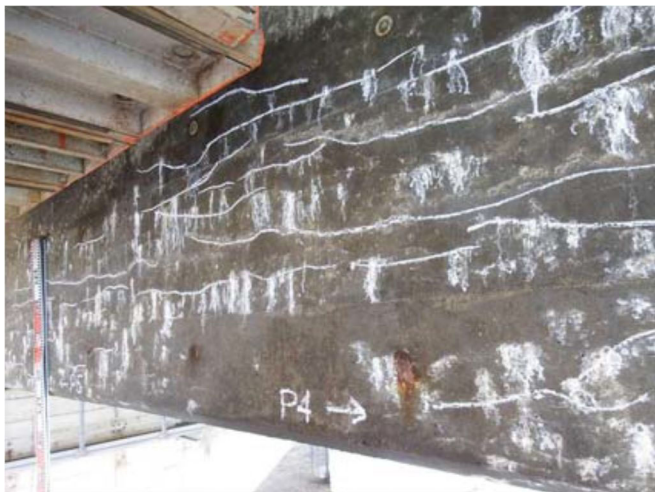
写真1-⑧ PC箱桁におけるASRの事例
