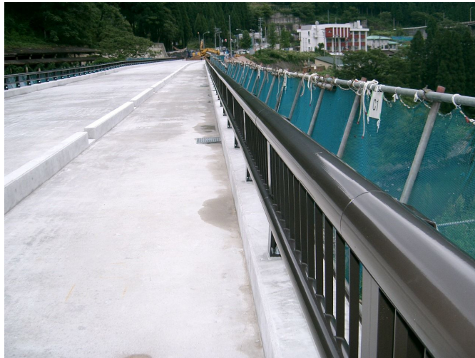
写真-解 8.3 床版上面の滞水
