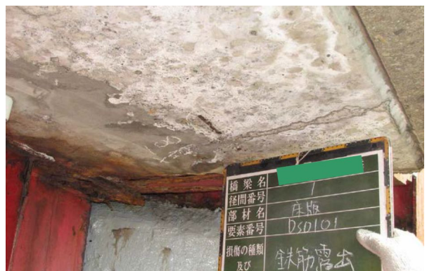
写真-解 1.6 塩害による鉄筋露出
