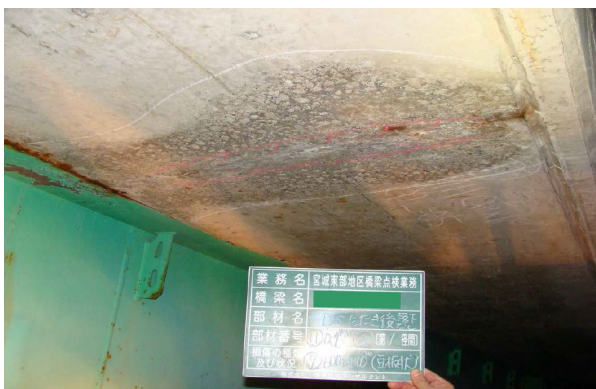
写真-解 1.7 床版打継目からの漏水
