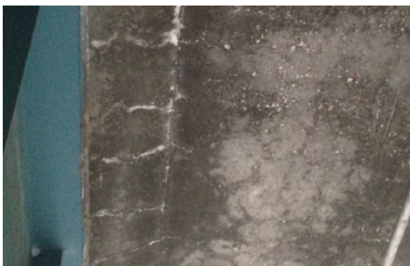
写真-解 1.5 ASRによるひび割れ 1)
