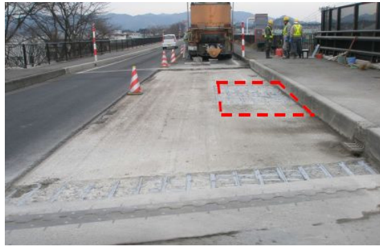
写真-資 3.2 床版コンクリート上面の損傷による補修事例
