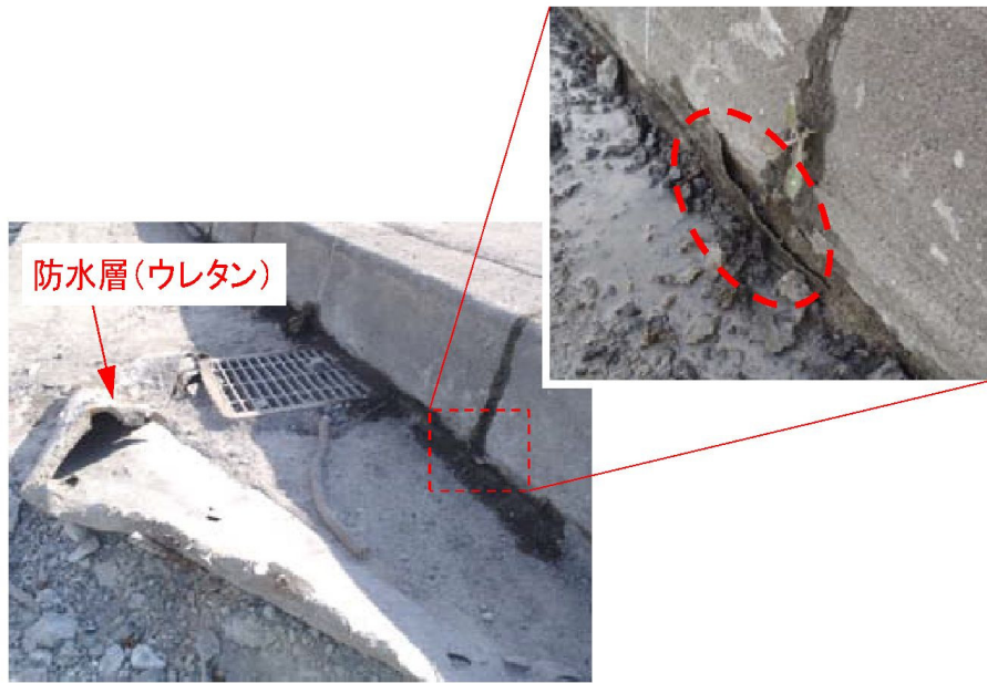
写真-解 8.1 排水柵まわりの損傷例
