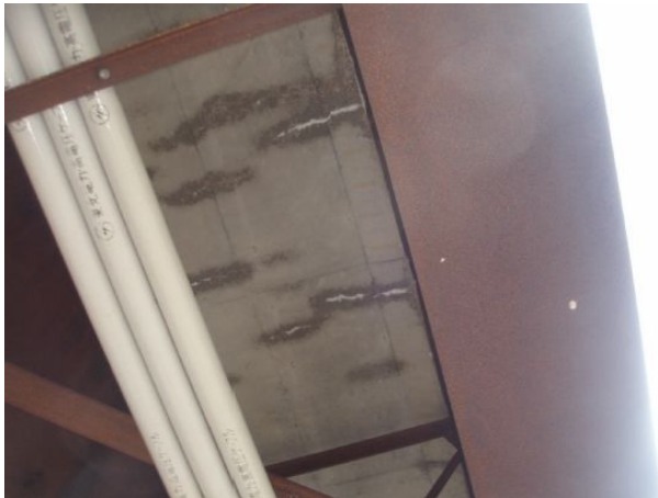
写真-解 1.2 主桁拘束と乾燥収縮ひび割れ
