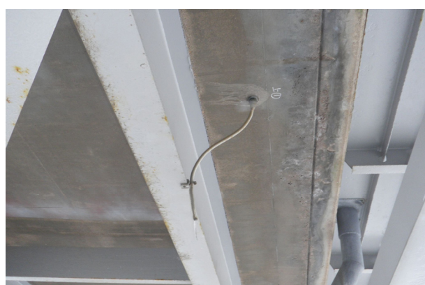
写真-解 1.10 スラブドレーン周辺の漏水
