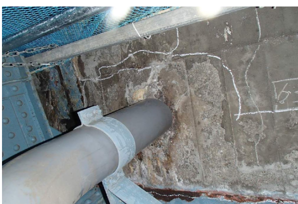
写真-解 1.9 排水柵周辺からの漏水
