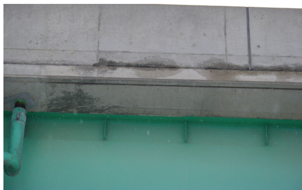
写真-解 1.8 床版と地覆の打継目からの漏水
