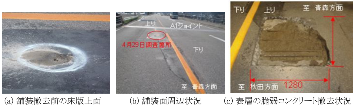
写真-解 1.1 東北地方で生じている床版上面の損傷例 (床版下面には有害なひび割れが観察されない場合もある)
