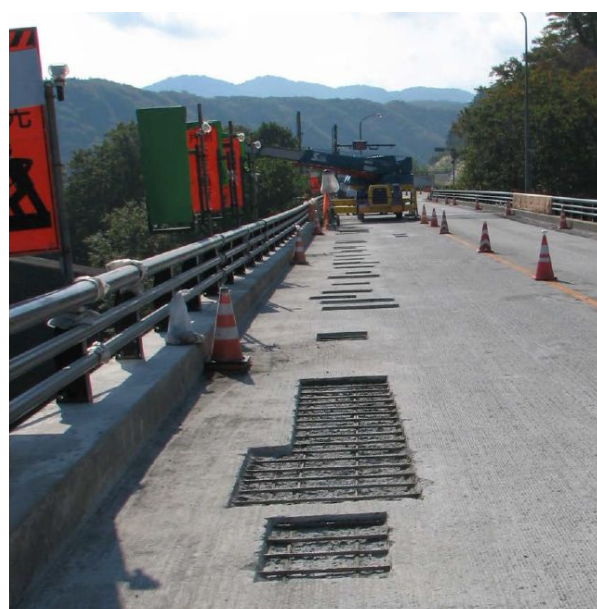
写真-解 1.12 走行車両の軌跡に沿ったコンクリートの浮き、剥離
