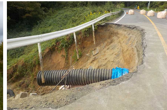
② 法面洗堀(いわき市好間地内)
