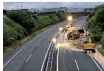
九州自動車道（横川～満辺鹿児島空港）の被害状況
