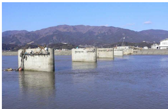
▲ 国道45号気仙大橋の橋桁流失 (陸前高田市)
