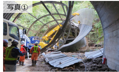
▲台風19号による被災状況 (宮古第3トンネル)
