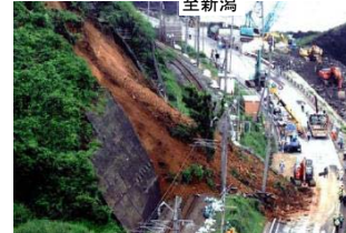
法面崩壊(鶴岡市小岩川地区)
