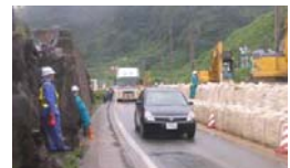
鶴岡市小岩川地内の片側交互通行の実施状況(約8日間実施) H18.7.13発生
