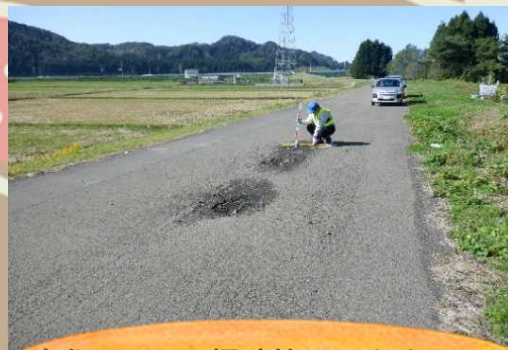
劣化している堤防等につきましては計画的に補修を行っていきます
