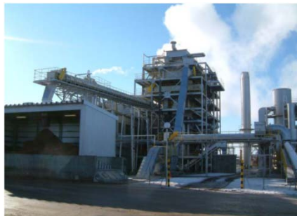
バイオマス発電施設
