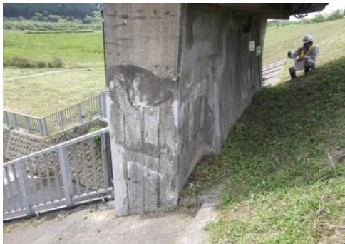
樋門門柱部の老朽化状況（監視・点検）
