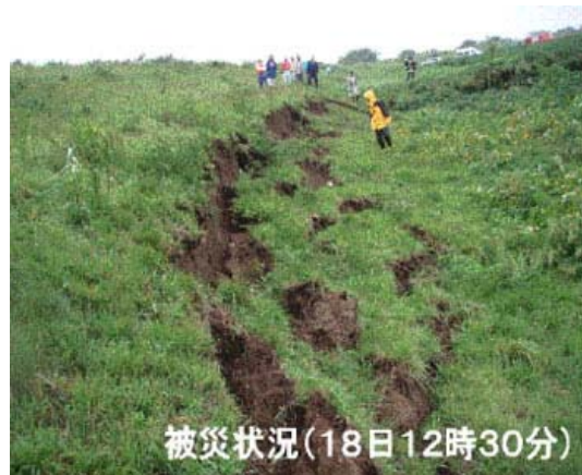
平成 19 年 9 月洪水堤防被災状況 (能代市扇田地区)
