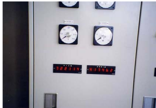
取水量計（能代市上水取水施設）
