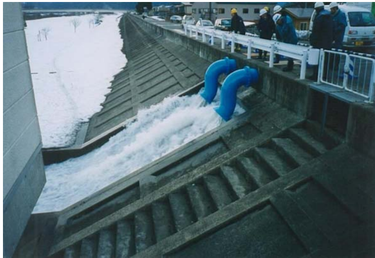
救急内水ポンプによる排除状況（能代市二ツ井町薄井地区）
