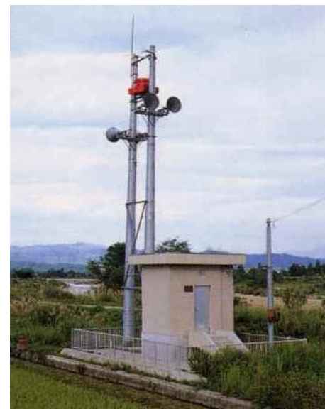
放流警報装置
