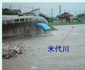
悪土川救急排水ポンプ（能代市）
