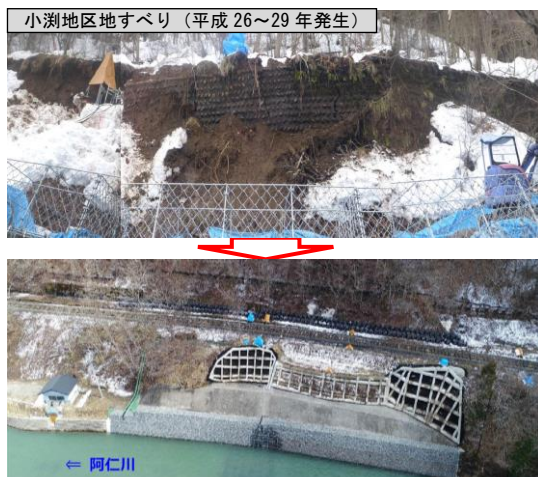
小淵地区地すべり防止施設 (平成 30 年完成 事業主体：秋田県)
