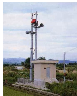
警報装置の状況
