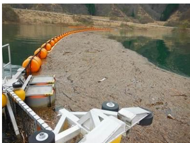
森吉山ダム 流木止施設
