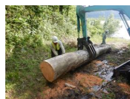
流木処理の状況
