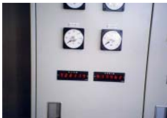
取水量計（能代市上水取水施設）
