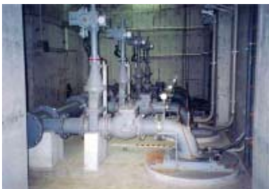
取水状況（能代市上水取水施設）
