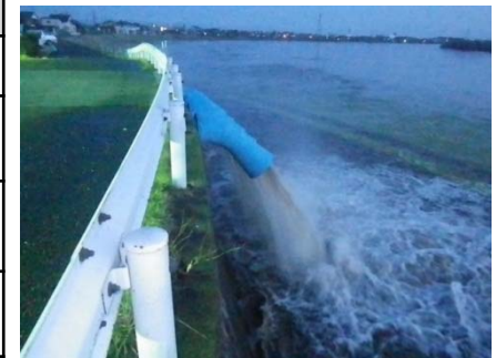
悪土川排水機場からの排水状況(4月4日)
