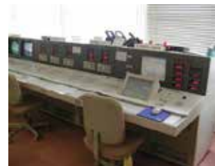
ダム放流制御設備
