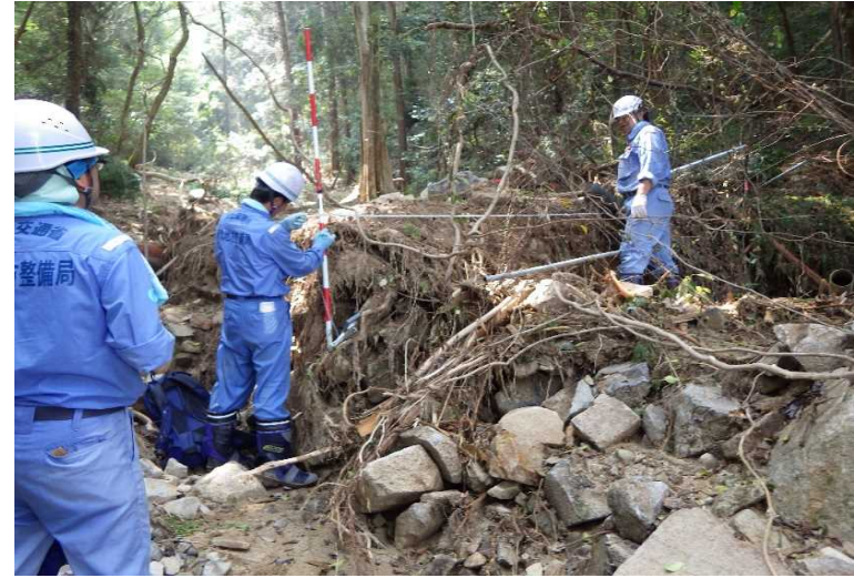
②被災状況調査(広島市安芸区中野東)
