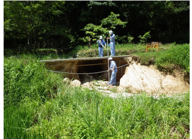
矢掛町小林地区の町道調査状況 (町道盛土材流失)(H30.7.22)
