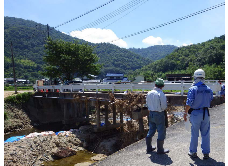
矢掛町内田地区の橋梁被災箇所にて自治会長より 地区の現状などを聞き取り(H30.7.22)
