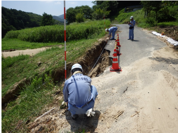
矢掛町上高末地区の町道調査状況 (町道路肩崩落)(H30.7.20)
