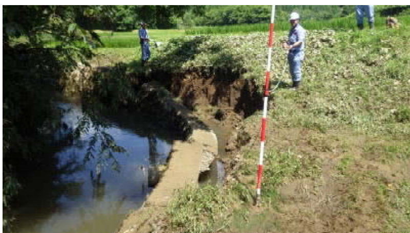
被災状況調査（大仙市：普通河川古種沢川）
