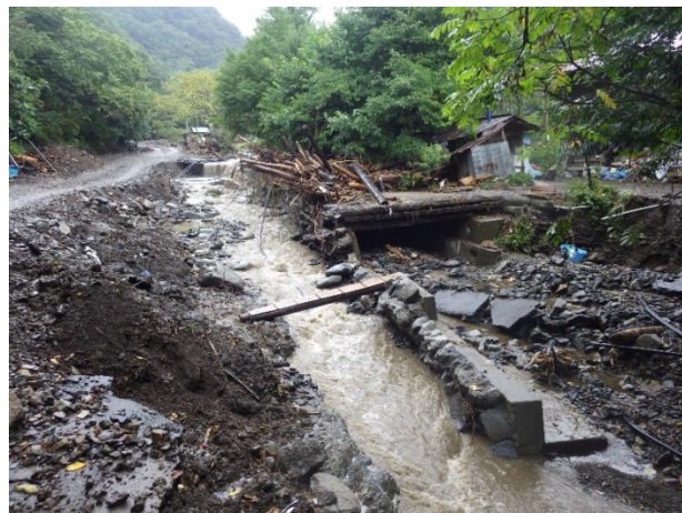
▲(準用河川)平沢川下流から全景被災状況
