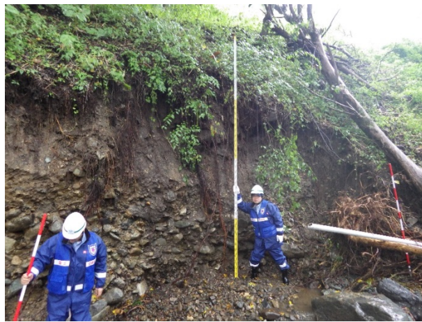
▲(普通河川)伊佐内沢川下流から全景被災状況
