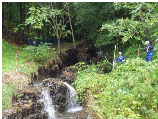
▲(普通河川)上ノ沢川下流から全景被災状況
