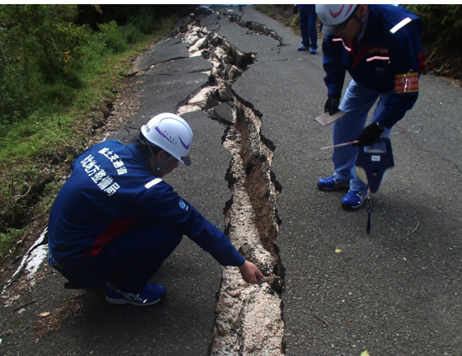
破断した町道を調査。
