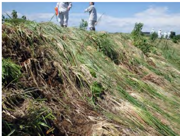
越水箇所の確認
