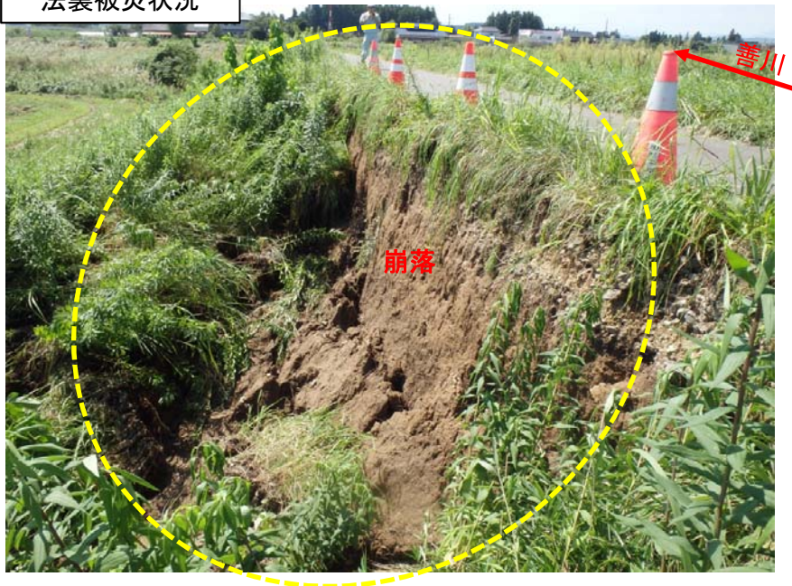
法裏被災状況
