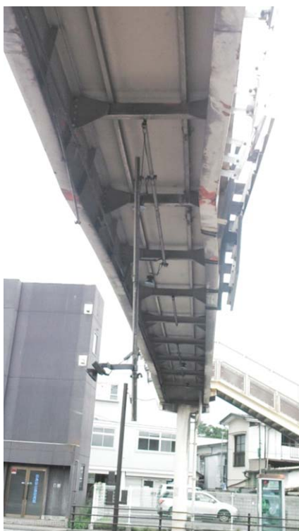
桁の損傷状況
