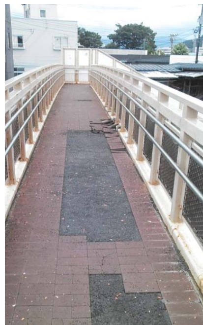
インターロッキングブロック損傷状況
