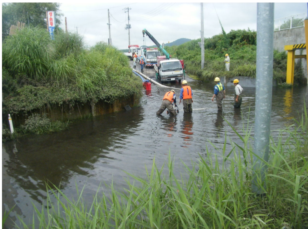
【 大館市道冠水状況 】 大館市松木地内
