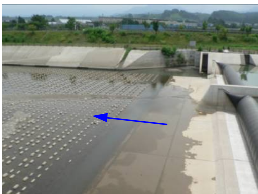
▲岩木川水系岩木川(青森県弘前市) 岩木川統合頭首工下流では水引きが露出 【平成24年8月2日撮影】
