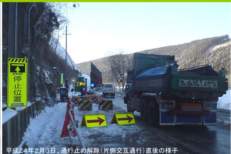
平成24年2月3日、通行止め解除(片側交互通行)直後の様子
