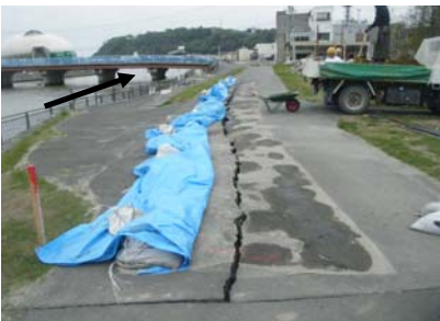
堤防の亀裂 石巻市中央(旧北上右岸2.6k付近) の応急対応の状況
