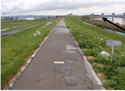
堤防の亀裂・沈下
