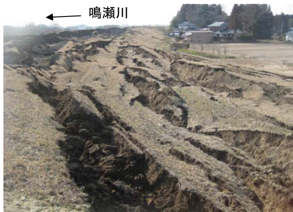
堤防被害状況 堤防沈下 3月13日 撮影
