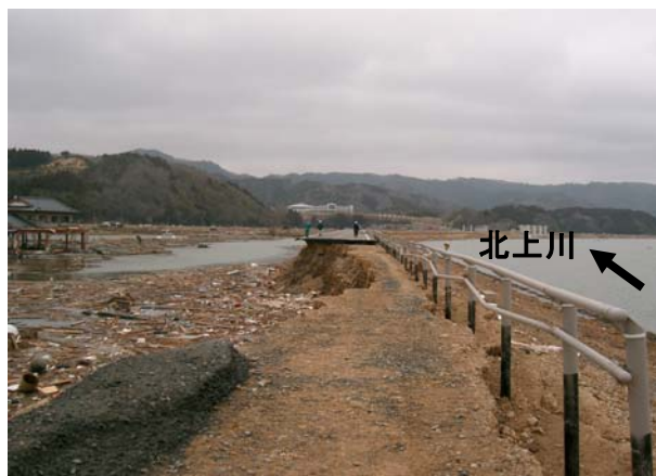
堤防被害状況 堤防決壊 3月15日 撮影
