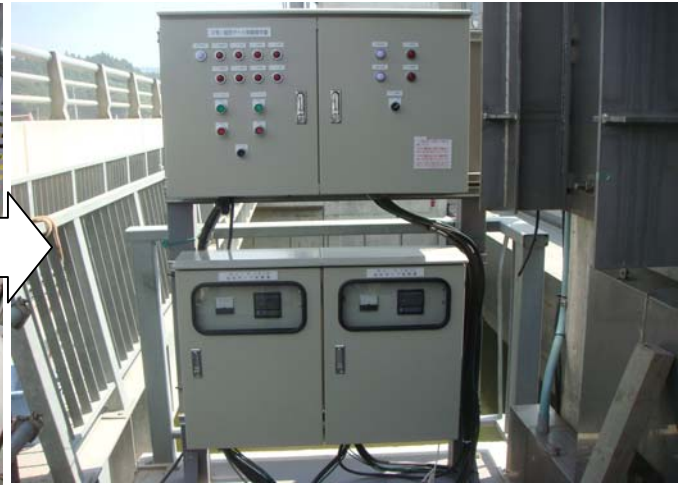
緊急復旧工事により仮設置された操作盤
