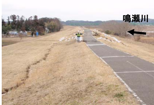
堤防被害状況 堤防沈下、亀裂、堤防斜面の崩壊 3月26日 撮影
