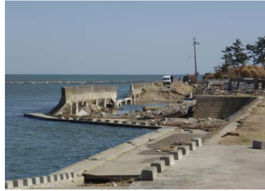
堤防被害状況 特殊堤流出
