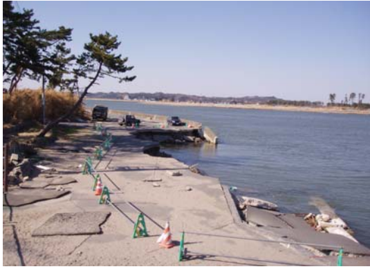
堤防被害状況 特殊堤流出
