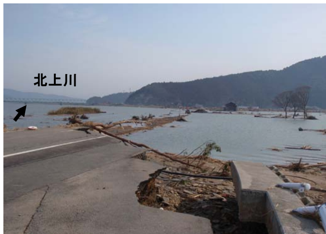
堤防被害状況 堤防決壊 3月13日 撮影
