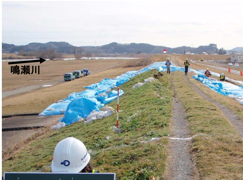
堤防被害状況 堤防沈下・亀裂 4月7日緊急復旧工事着手 3月22日 撮影
