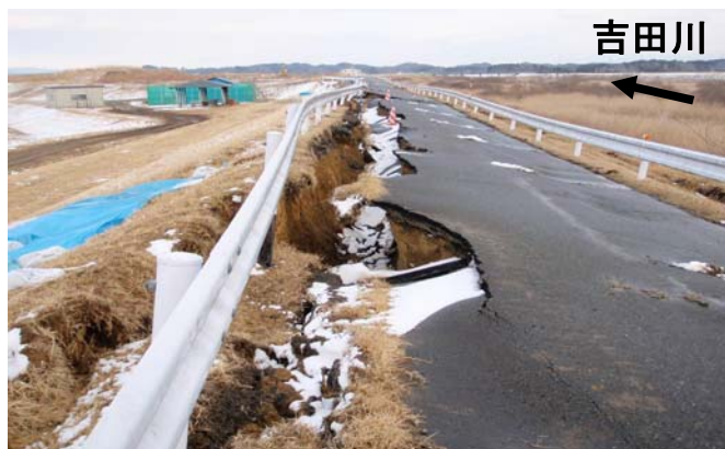
堤防の被災状況
