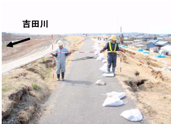
堤防の被災状況
