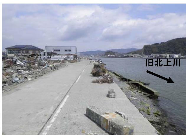
緊急高潮対策、実施前の状況 5月 5日撮影 (石巻市門脇町)
