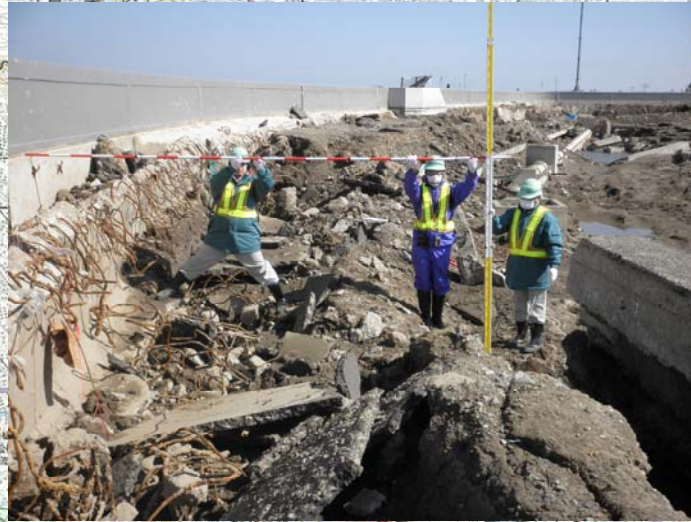
0.2k付近の被災状況
