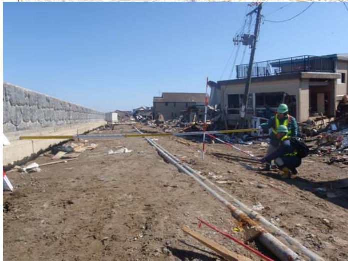
0.4k付近の被災状況
