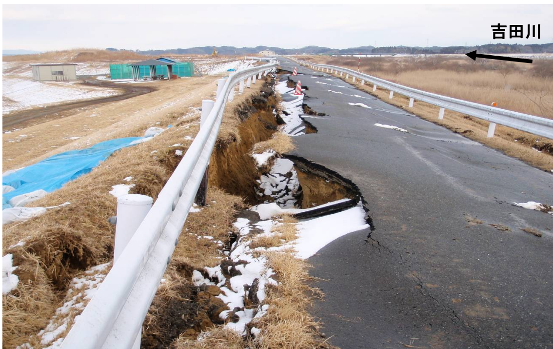
堤防の被災状況
