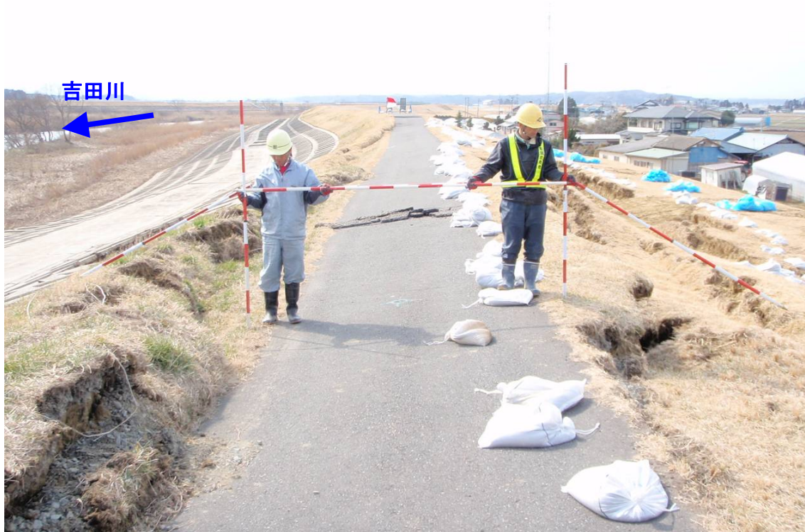
堤防の被災状況
