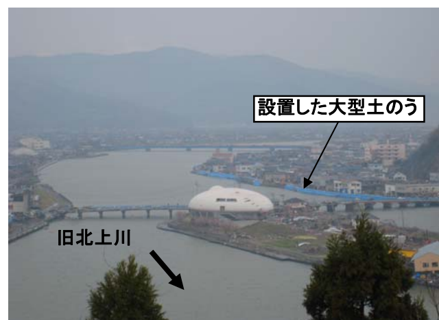
緊急高潮対策、現在の設置状況 (石巻市八幡町)
