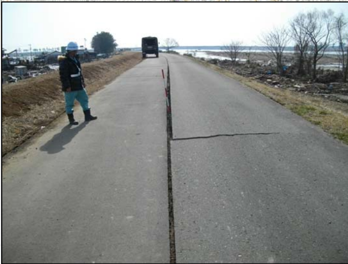
2.0k付近の被災状況
