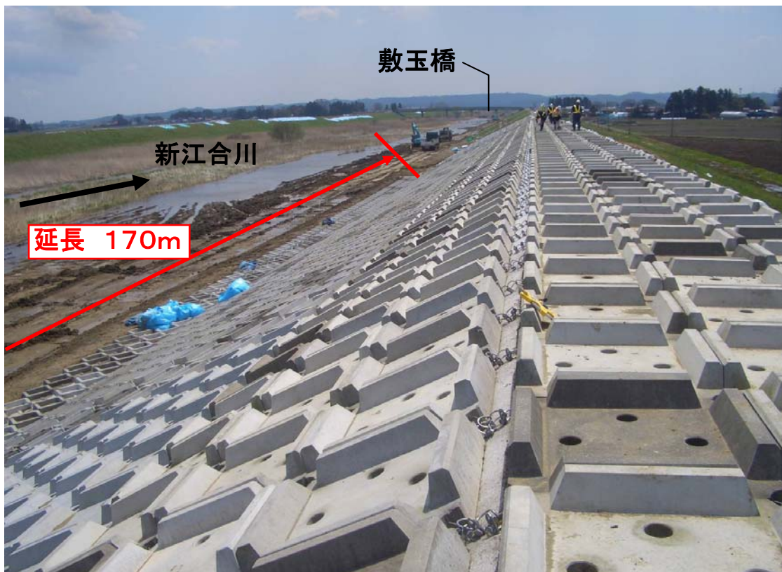
緊急復旧工事の実施状況 コンクリートブロック張り完了 ※ 4月28日撮影
