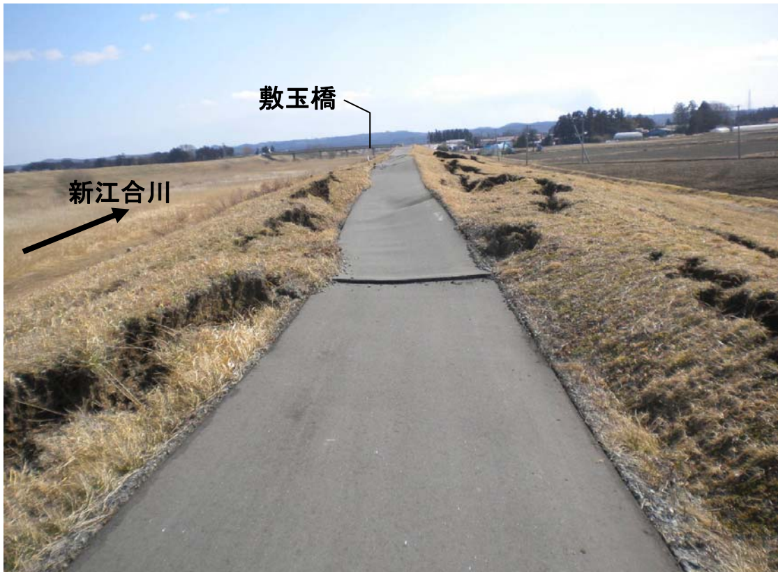
堤防の被災状況 堤防沈下、堤防斜面の崩れ
