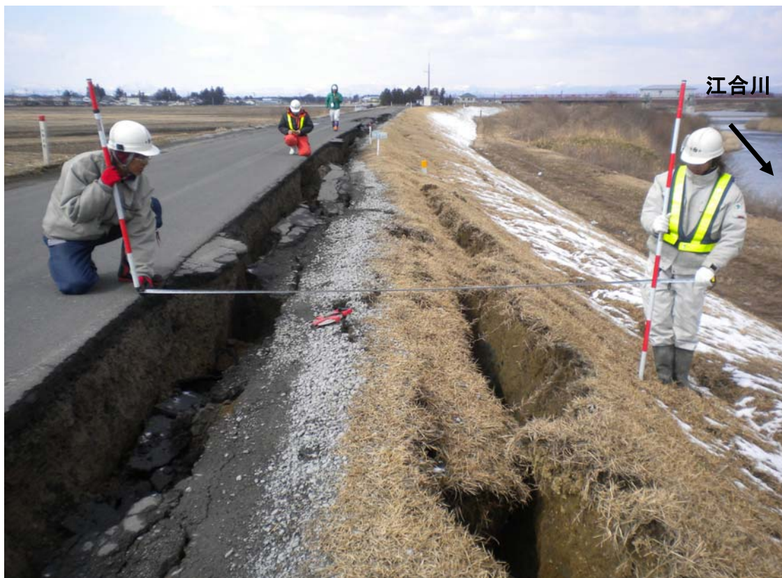
堤防の被災状況 堤防亀裂、堤防斜面の崩れ
