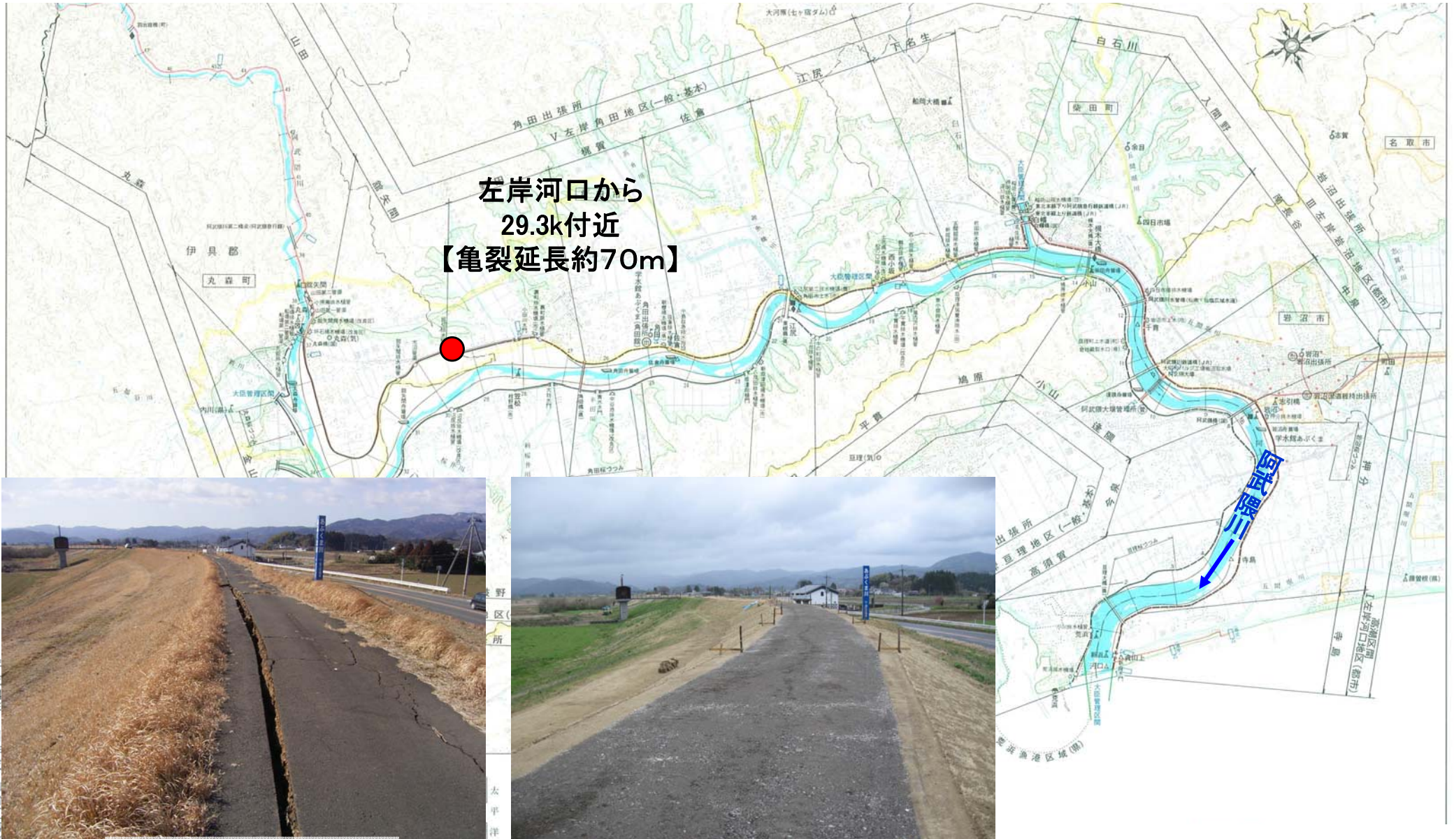
29.3k付近の被災状況
