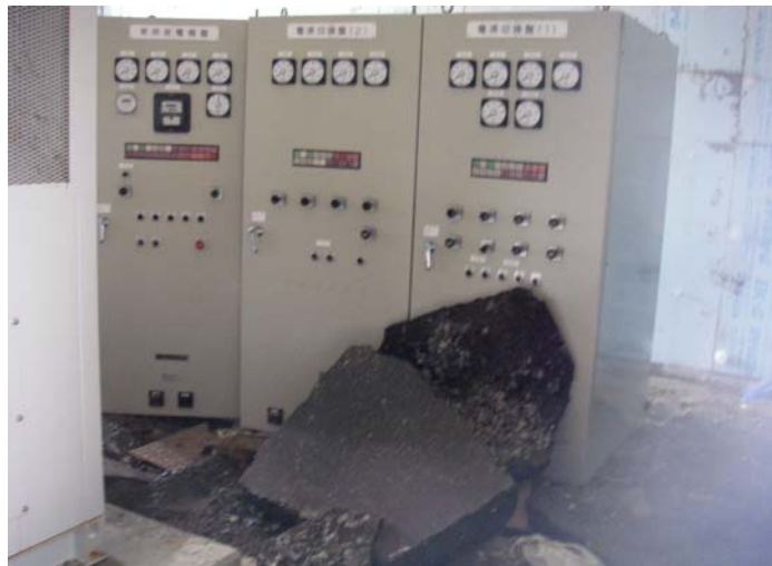
水門設備(電源盤)の被災状況
