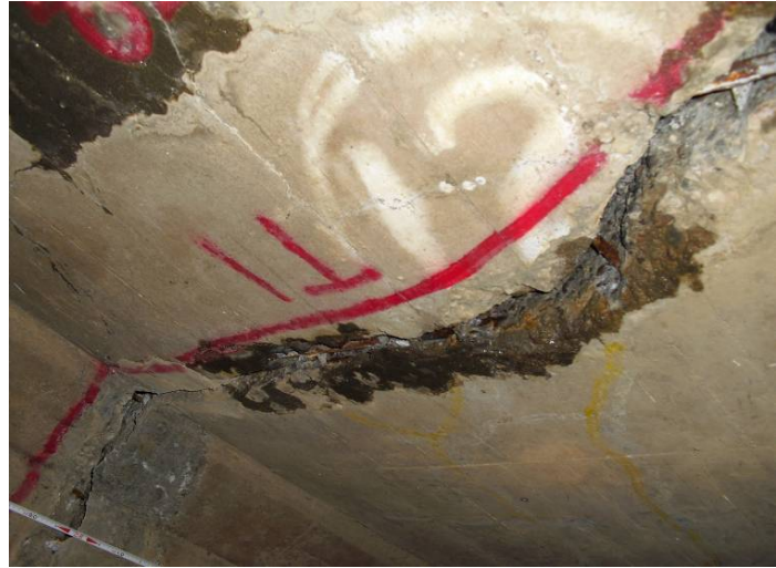
函体の亀裂・沈下状況
