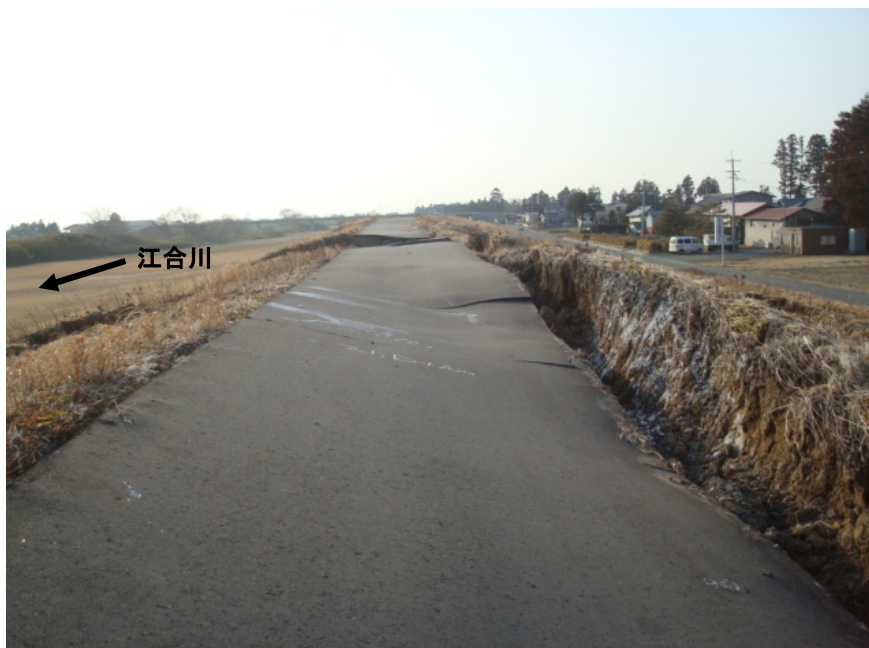
堤防の被災状況 堤防沈下・亀裂
