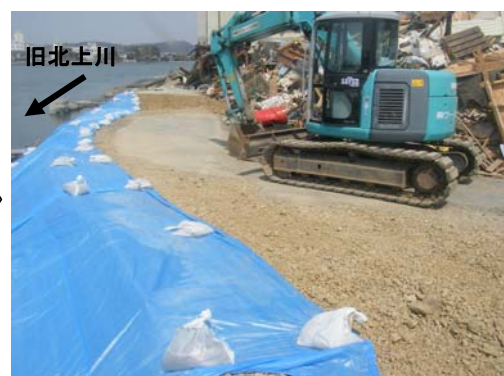
②緊急対策実施箇所 石巻市八幡の緊急対策状況 ※ 4月13日撮影
