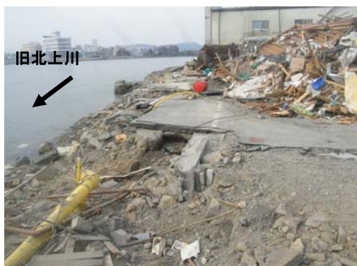
石巻市八幡の護岸の決壊
