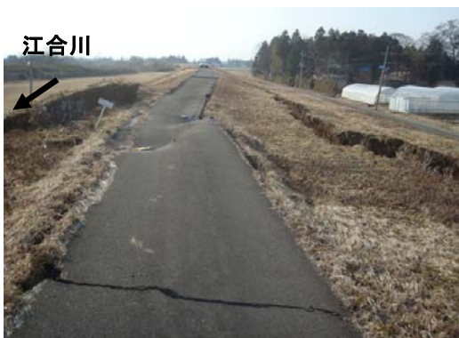
堤防被害状況 堤防沈下・斜面の崩れ ※ 3月11日撮影
