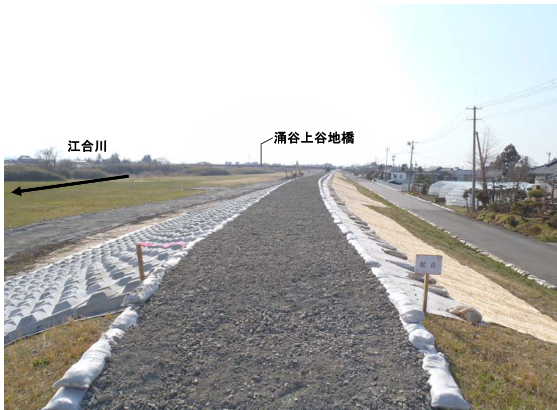
コンクリートブロック張り完了 緊急復旧工事概成状況
