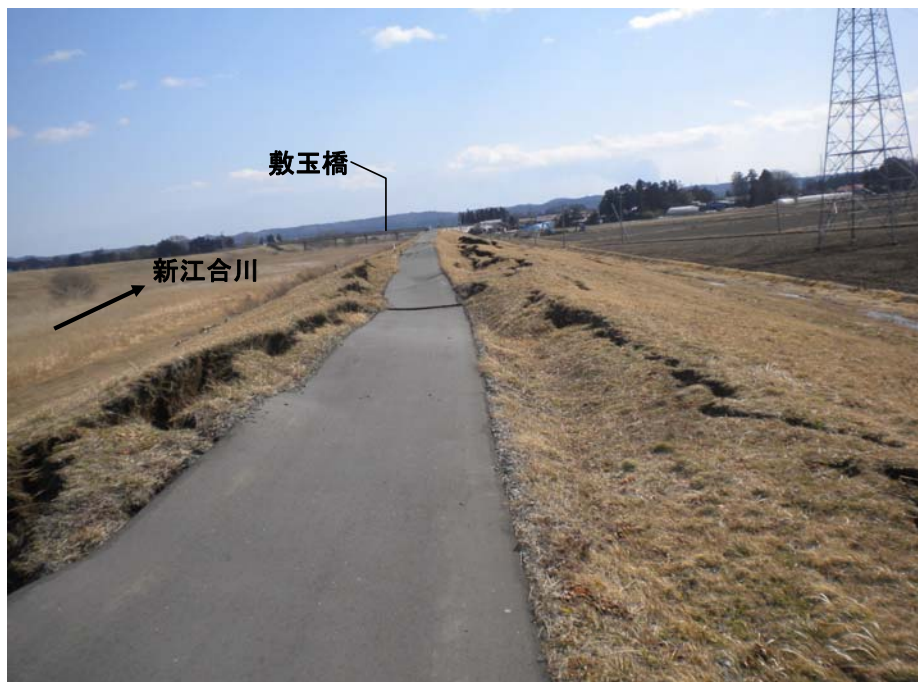
堤防の被災状況 堤防沈下・斜面の崩れ・護岸損傷 ※ 3月12日撮影
