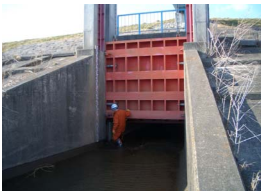
吉田川 内浦排水樋管 大崎市鹿島台木間塚
