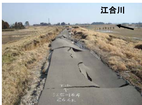
堤防被害状況 堤防亀裂・沈下 ※ 3月11日撮影
