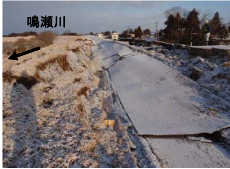
堤防被害状況 堤防沈下・斜面の崩れ ※ 3月12日撮影
