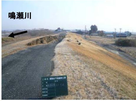
堤防被害状況 堤防沈下 ※ 3月13日撮影
