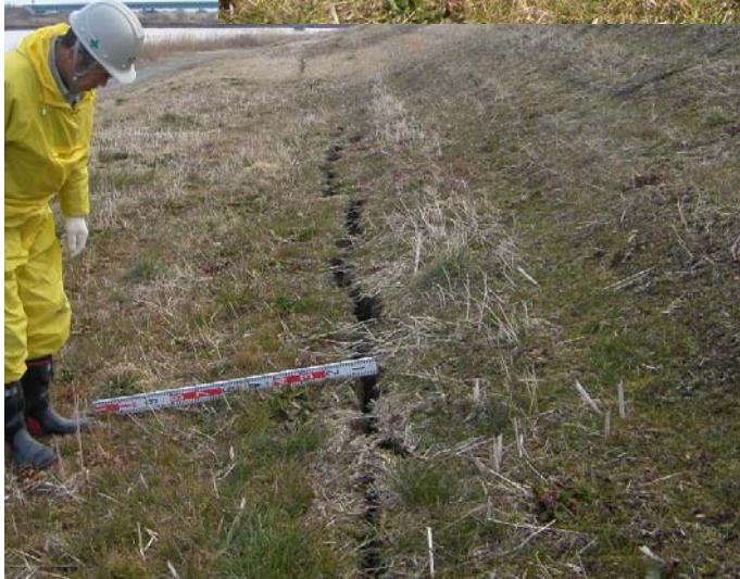
亀裂幅 約15cm
