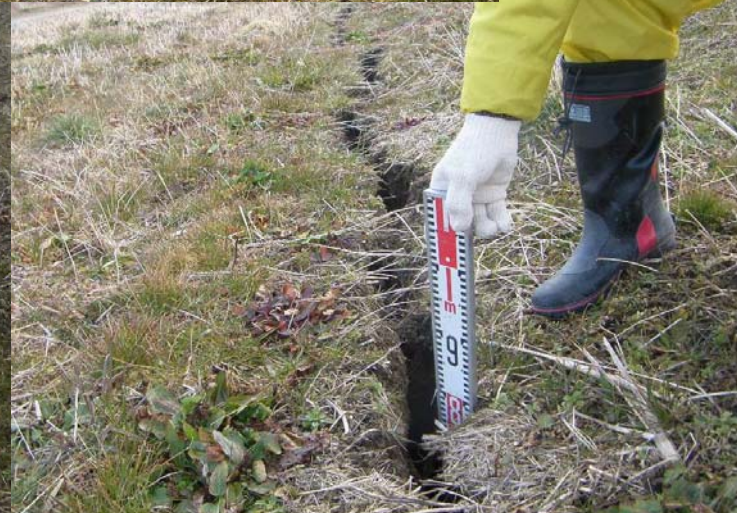
亀裂深さ 約90cm
