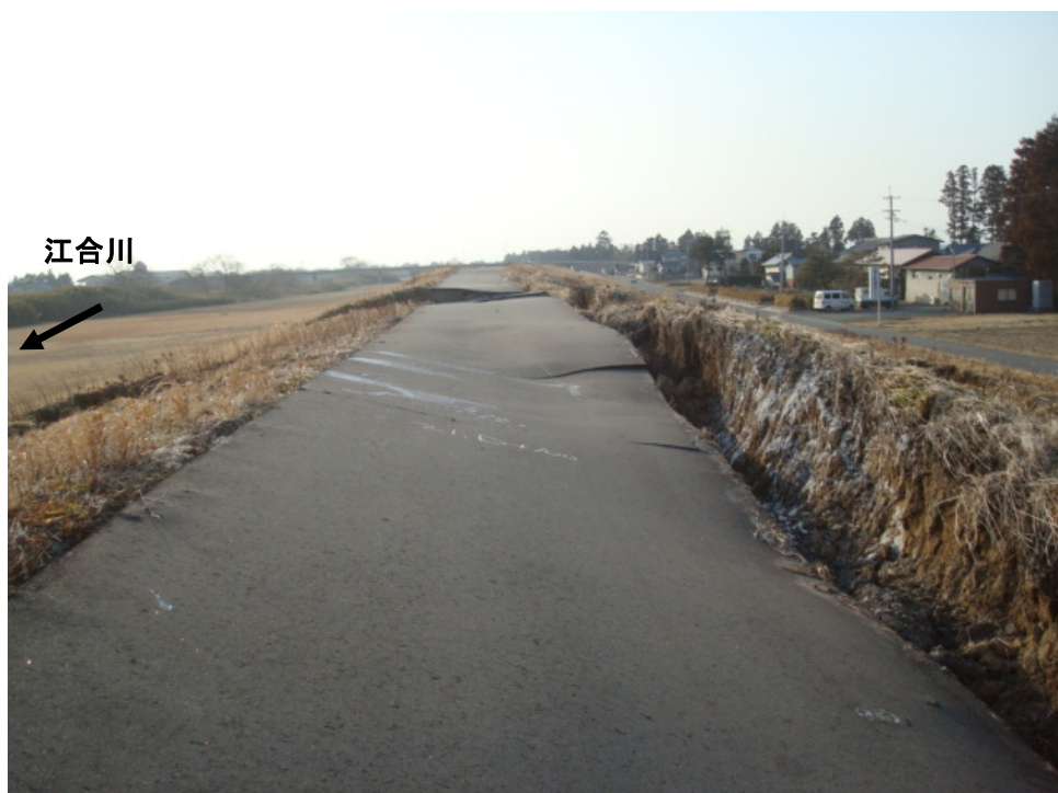
3月11日 堤防の被災状況 堤防沈下・亀裂
