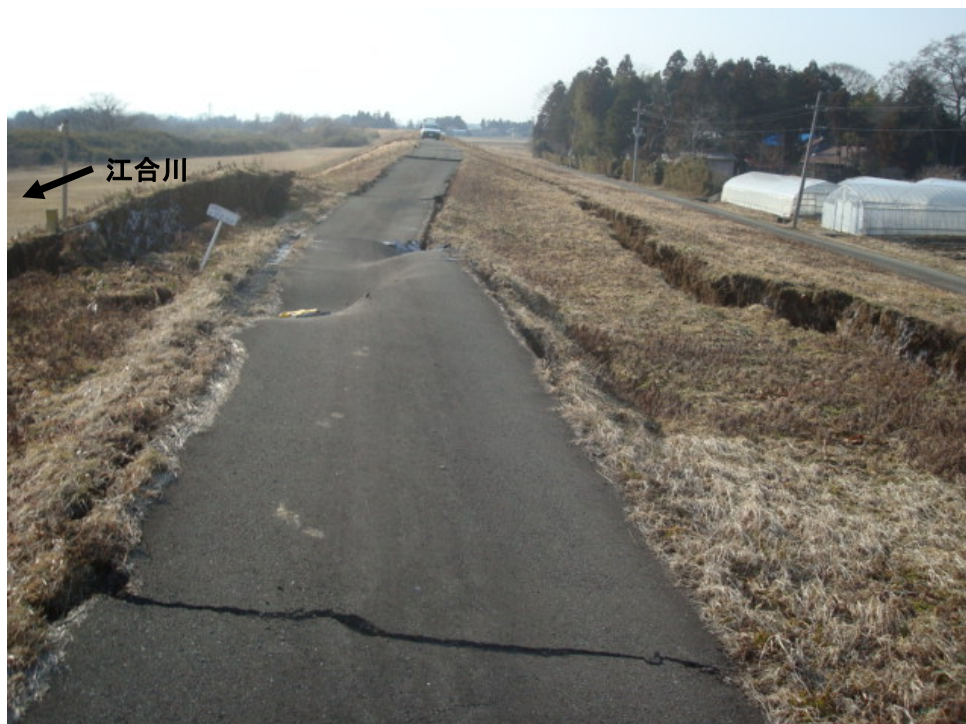
3月11日 堤防の被災状況 堤防沈下・斜面の崩れ
